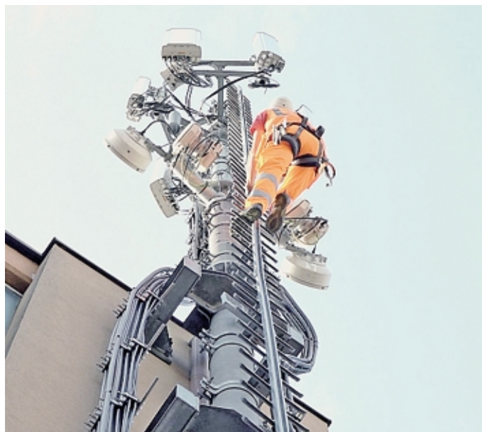
Il core business di Valtellina sono le infrastrutture TIC
